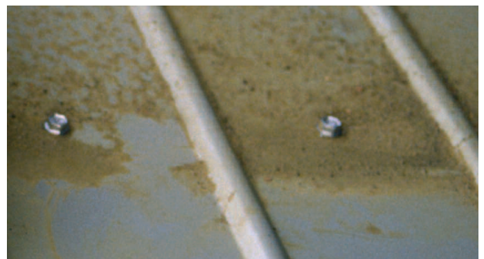
Croissance des moisissures sur l'acier prélaqué.
