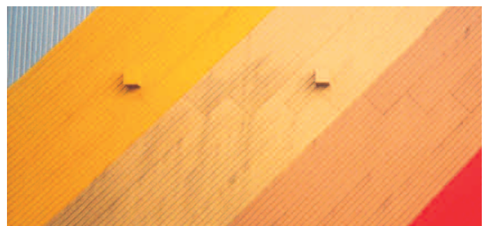
Dépôts d'impuretés sur le bardage.
